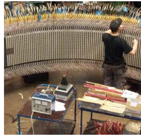
Uppgradering av generatorer
